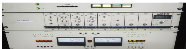
Figura 3.11: Imagen del excitador que se encuentra en el cerro Pichincha.
